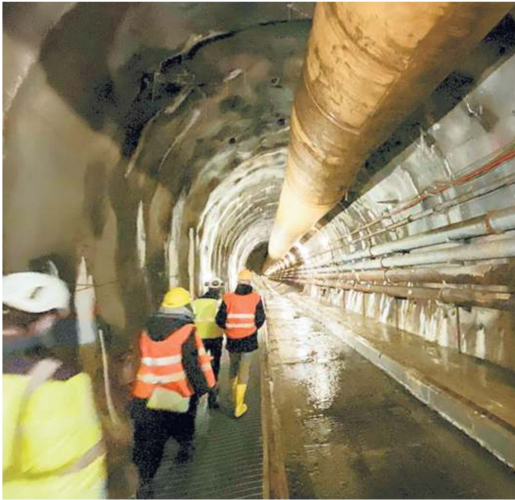
Telt assegnerà a breve i lavori per la tratta italiana del tunnel di base, si scaverà da Chiomonte
