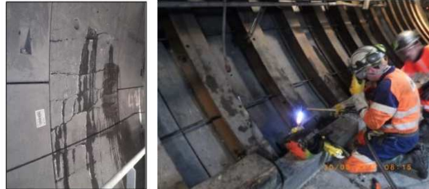
Figure 6: Voussoirs fissurés et renforcement avec cintres HEB
